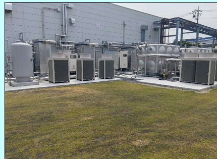
【屋外設置機器】
