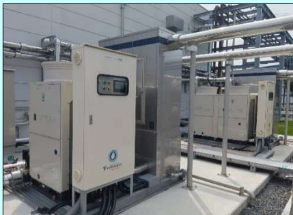
【OMAチラー（屋外設置）】
