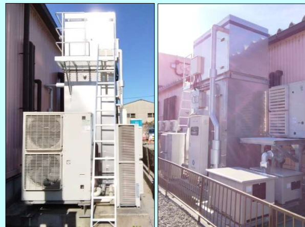
【AHP氷蓄熱チラーユニット（屋外設置）】
