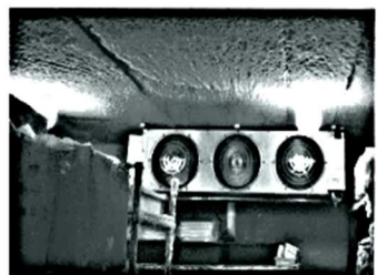
Fig. 2 TKSシステム稼働前の庫内写真
