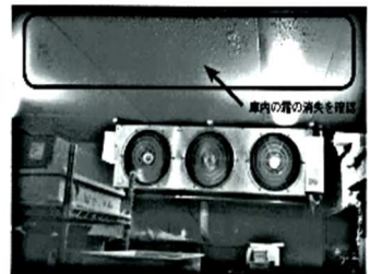
Fig. 3 TKSシステム稼働89日後の庫内写真
